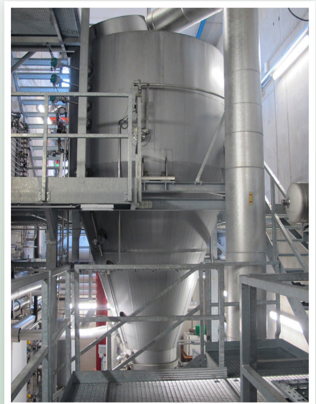
Schwebbett-Reaktor im Heizkraftwerk
