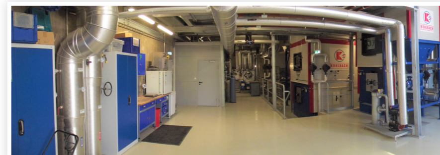
Für die zuverlässige Wärmeversorgung in Bad Mitterndorf sorgen zwei Kohlbach-Kessel mit 5,5 MW.
