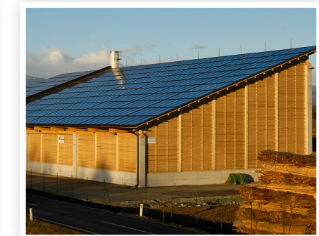
Thermische Solaranlage Gleinstätten
