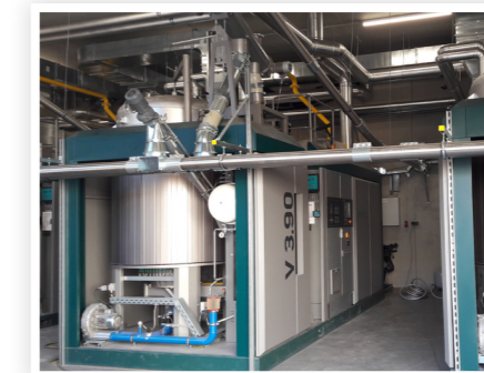
Holzvergaseranlage St. Michael
