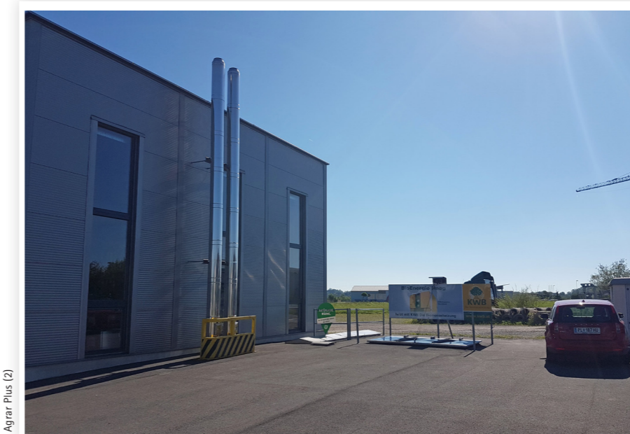
Betriebsgebiet Haag: Unterflur-Biomasseanlage mit 2 x 150 kW
