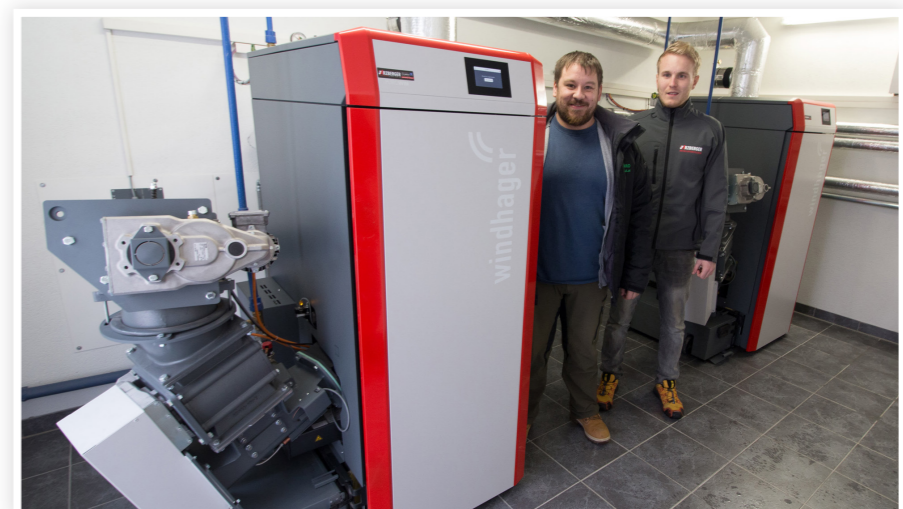
Für den großen und individuellen Leistungsbedarf: Hausherr Karl Eichtinger (li.) und David Arzberger von Arzberger Installationen sind stolz auf die Windhager-Hackgutkaskade.
