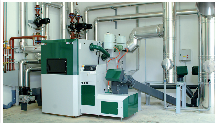
Die Hackgutheizung von Herz verhilft der Gärtnerei zu einer jährlichen Kosteneinsparung von 40.000 Euro.
