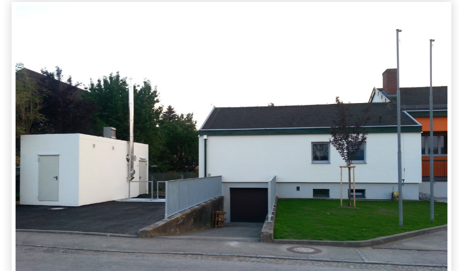
Groß-Siering: Containerlösung der Bioenergie NÖ für die sanierte Volksschule des Ortes
