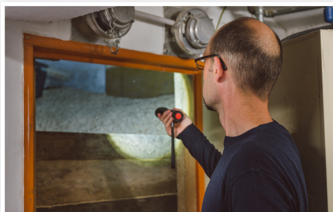
Im Lagerraum im Keller geht sich exakt ein Jahresbedarf an Pellets in der Höhe von etwa 4 Tonnen aus.
