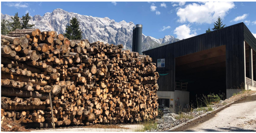
Das Biomasseheizwerk in Dienten am Hochkönig versorgt öffentliche Gebäude, Hotels und Haushalte mit Wärme – die Erzeugung biogener Fernwärme in Salzburg hat sich in den letzten 15 Jahren vervierfacht.
