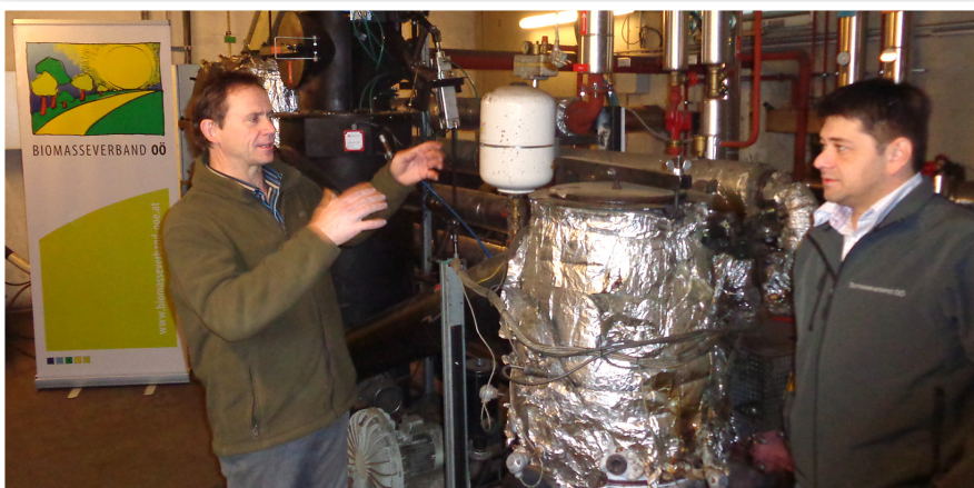
Mehrere Biomasse-KWK-Anlagen auf Basis Holzvergasung von 20 kW bis 500 kW wurden in den letzten Jahren mit dem Biomasseverband OÖ realisiert und sind erfolgreich mit hoher Auslastung in Betrieb.
