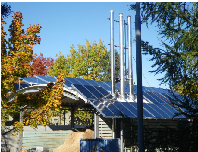
Heizhaus der Nah-Wärme Maria Gail
