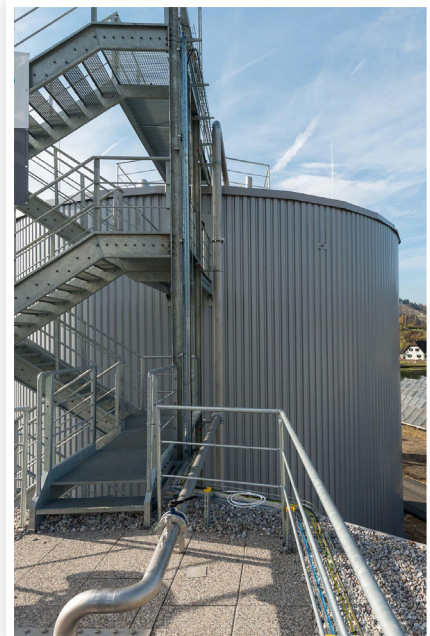
Die Biertrebervergärungsanlage erzeugt Biogas, das zur Dampferzeugung genutzt wird.
