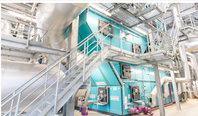
10 MW-Sattdampfkesselanlage mit hydraulischer Vorschubrostfeuerung
