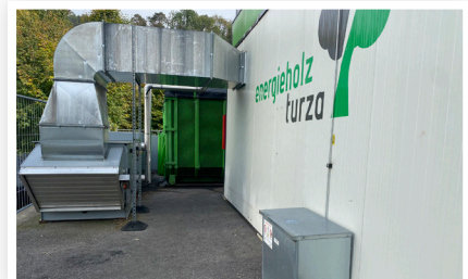
Abwärme wird zur Hackgutrocknung genutzt.
