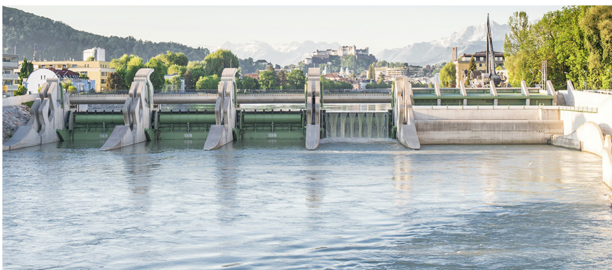
Das Wasserkraftwerk Sohlstufe Lehen an der Salzach beliefert etwa 23.000 Haushalte mit Strom.
