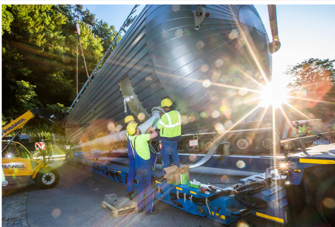
Aufbau des Großpufferspeichers, der Teil des Multi-Supply-Systems der Fernwärme Villach ist – das größte Fernwärmenetz der Kelag Energie & Wärme
