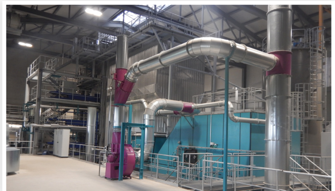
22 MW th -Altholzverbrennungsanlage mit 6,5 MW el Stromerzeugung in der Schweiz
