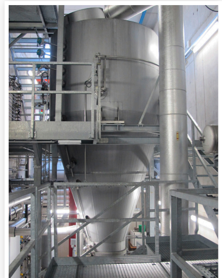
Schwebebett-Reaktor im Heizkraftwerk
