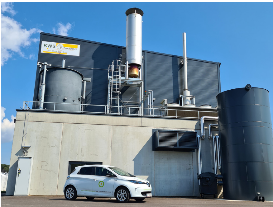
Das von Riebenbauer geplante Holzgaskraftwerk Ternitz wurde als BHKW des Jahres 2021 ausgezeichnet.
