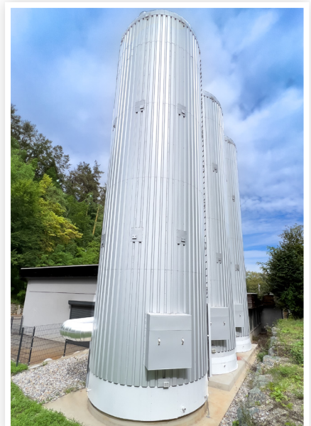
Der Großpufferspeicher besteht aus drei 16 m hohen Stahl-Druckbehältern mit 450 m 3 Inhalt.
