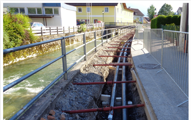
In Oberösterreich gibt es mehr als 470 regionale Biomasseheizwerke, die über eine Trassenlänge von gut 800 km ihre Abnehmer mit Wärme versorgen.
