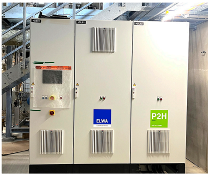
Power-to-Heat: Überschüssiger Strom wird hier in Wärme umgewandelt.
