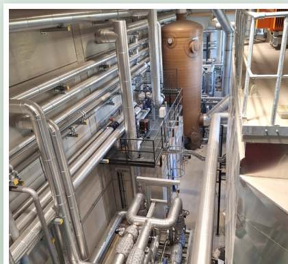
Über eigene Leitungen wird das aus Abgasen abgeschiedene CO 2 ins Gewächshaus transportiert.
