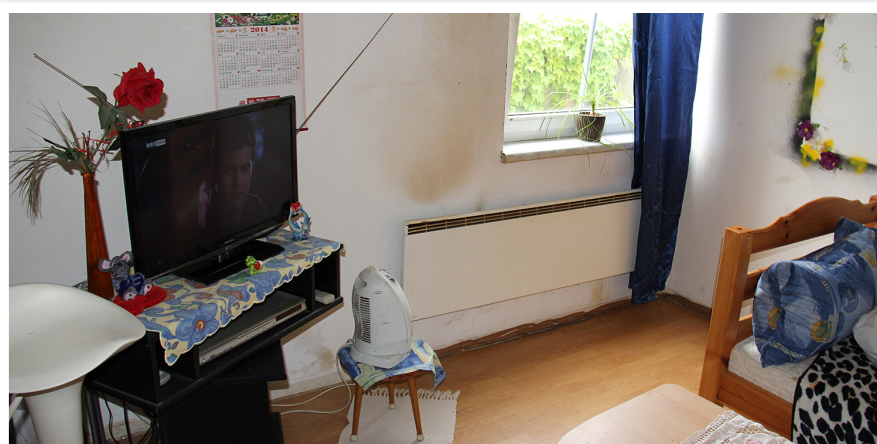
Feuchte Wand und ein teures Zusatzheizsystem in einem energiearmutsgefährdeten Haushalt
