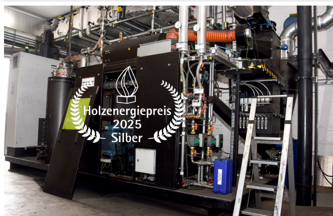
Das Blockheizkraftwerk im Wolfsberger Wirtschaftshof produziert gleichzeitig Wärme und elektrischen Strom.
