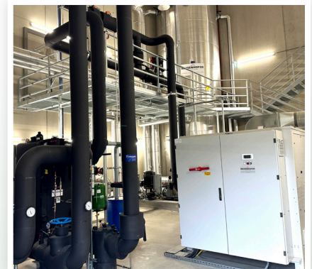
Die Wärmepumpe gewinnt Wärme aus dem gereinigten Abwasser und speist sie ins Netz ein.
