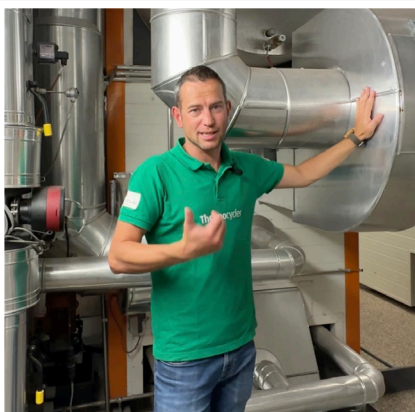
Vorbildlich gedämmt wurden Rohrleitungen und Rauchgasventilator, zeigt Mario Rauter.
