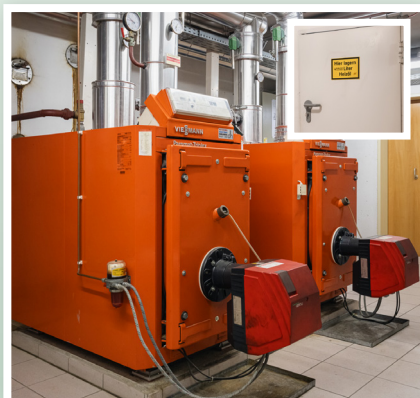
Die alte Ölheizung kam raus, und auch ein Öltankraum für 45.000 Liter Öl wurde eingespart.
