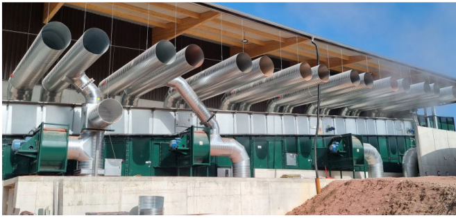
Die Trocknungsanlage für Mais oder Luzerne wird mit einer innovativen Heißluftherzeugung aus der Biomasseverbrennung betrieben.
